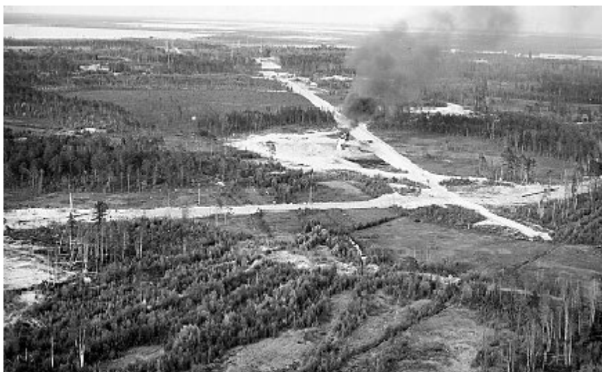
Рис. 6.7. Песчаные насыпи коридоров коммуникаций нефтяного месторождения, проходящие через геосистемы открытых болот (фото В.В. Хромых с вертолёта, 1993 г.)
